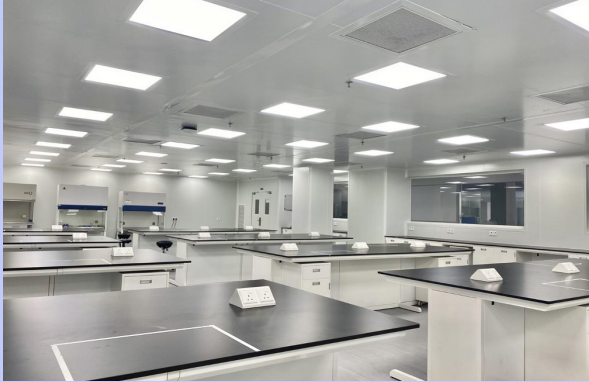
2e) Clean Room
