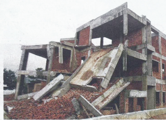
BEGINILAH keadaan anjung sebuah rumah banglo dalam pembinaan yang runtuh hingga mengakibatkan seorang buruh warga Indonesia di Bukit Jalil, Kuala Lumpur semalam.
