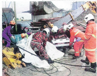
Anggota Bomba dan Penyelamat mengeluarkan mangsa dihempap kren tumbang di tapak projek perumahan Taman Capital Tanjung Tiang di Kota Samarahan, semalam.
